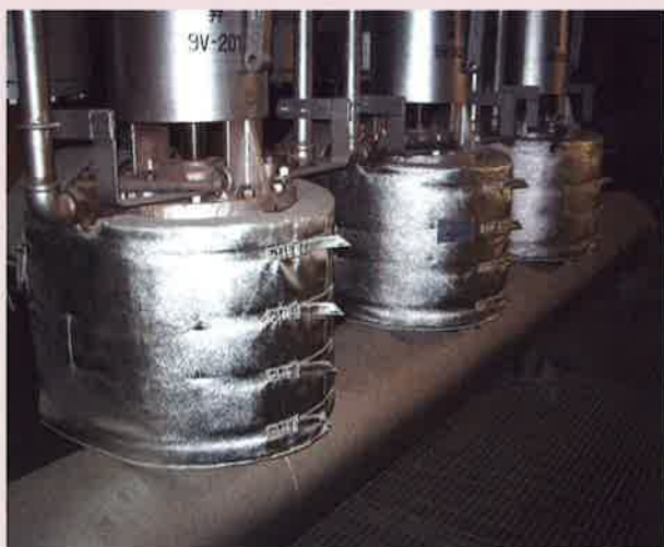
蒸気ヘッダー(外被材:アルミガラスクロス)
