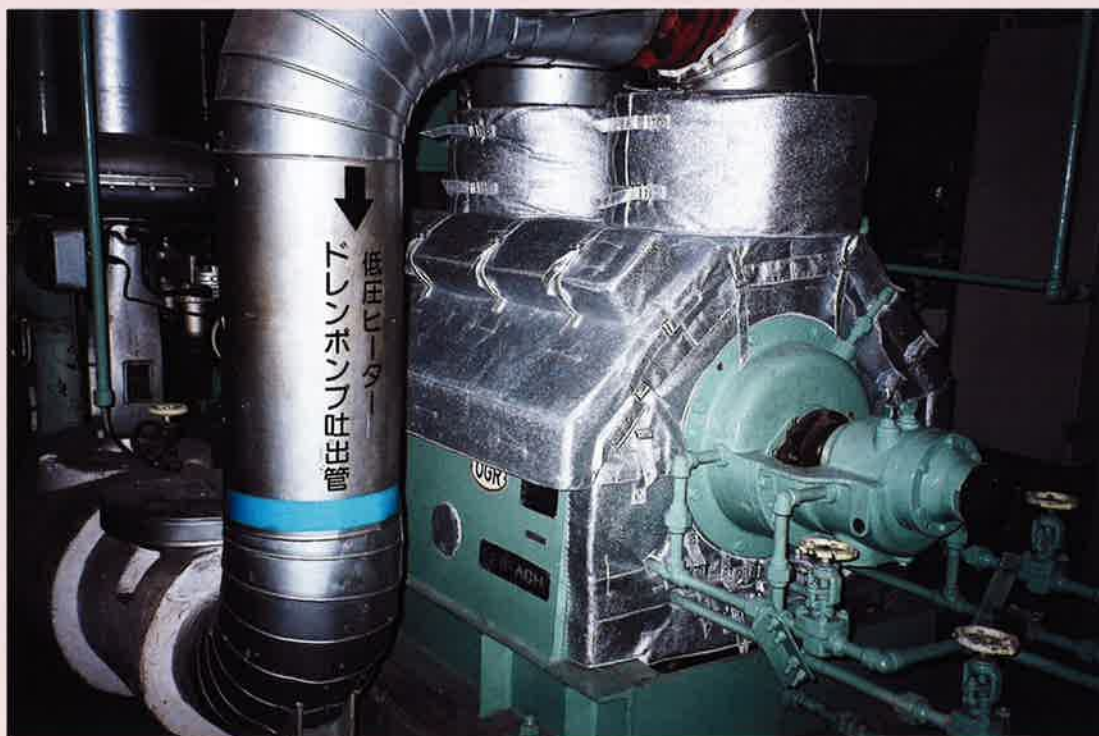
ドレンポンプ(外被材:アルミガラスクロス)
